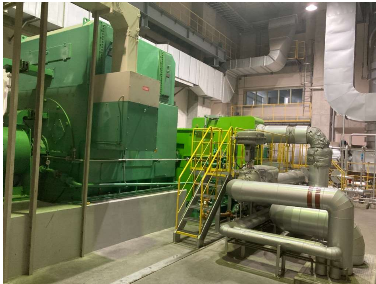
※蒸気タービンの外観写真
